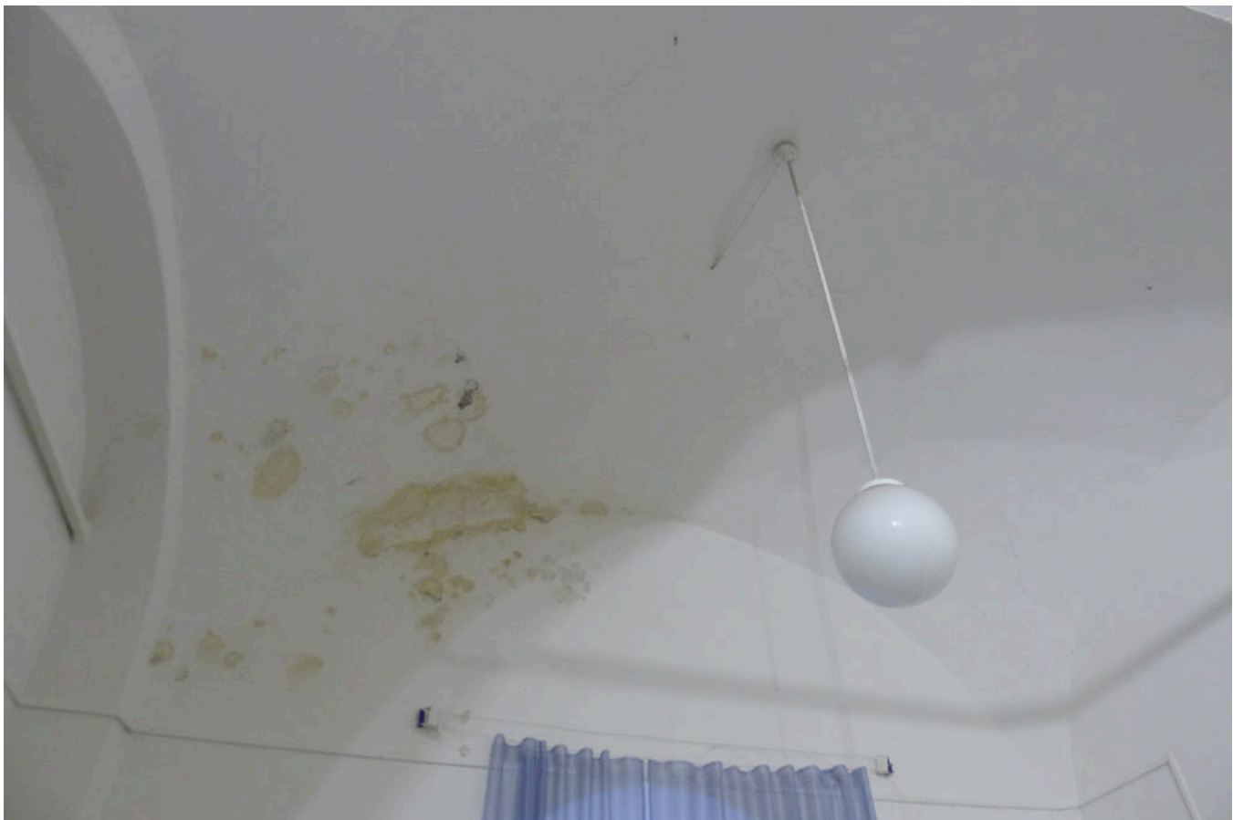
Фото 25. Вспарушенный свод северной части алтаря.
